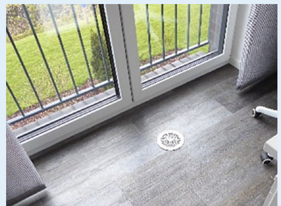
Abbildung 7b: Zuluftventil aus dem Boden
