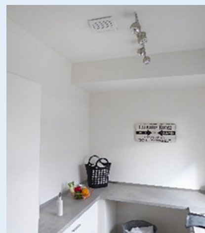
Abbildung 6a: Abluft im HWR mit Ventil incl. Luftfilterung
